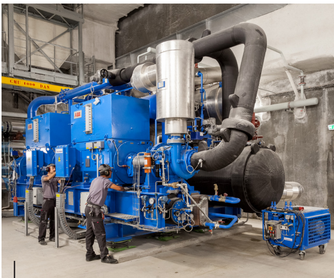
Installation de la première thermo-frigo-pompe, la plus importante d'Europe
